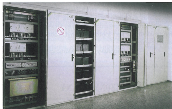
Az MPQ típusú rendszer a Győr MÁV állomáson
